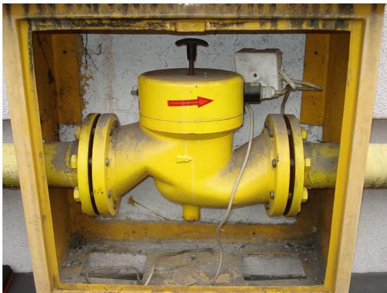
Zdj. Nr 2 – zawór odcinający gaz dla Kotłowni nr 2 – Pawilon C'
