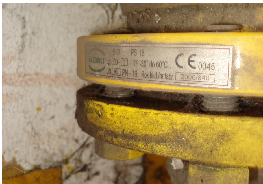
Zdj. Nr 3 – zawór odcinający gaz dla Kotłowni nr 2 – Pawilon C'
