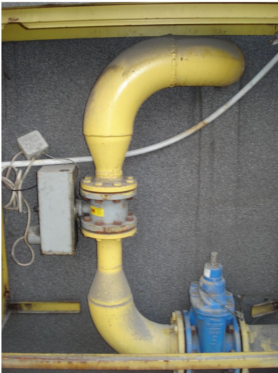
Zdj. Nr 1 – zawór odcinający gaz dla Kotłowni nr 1
